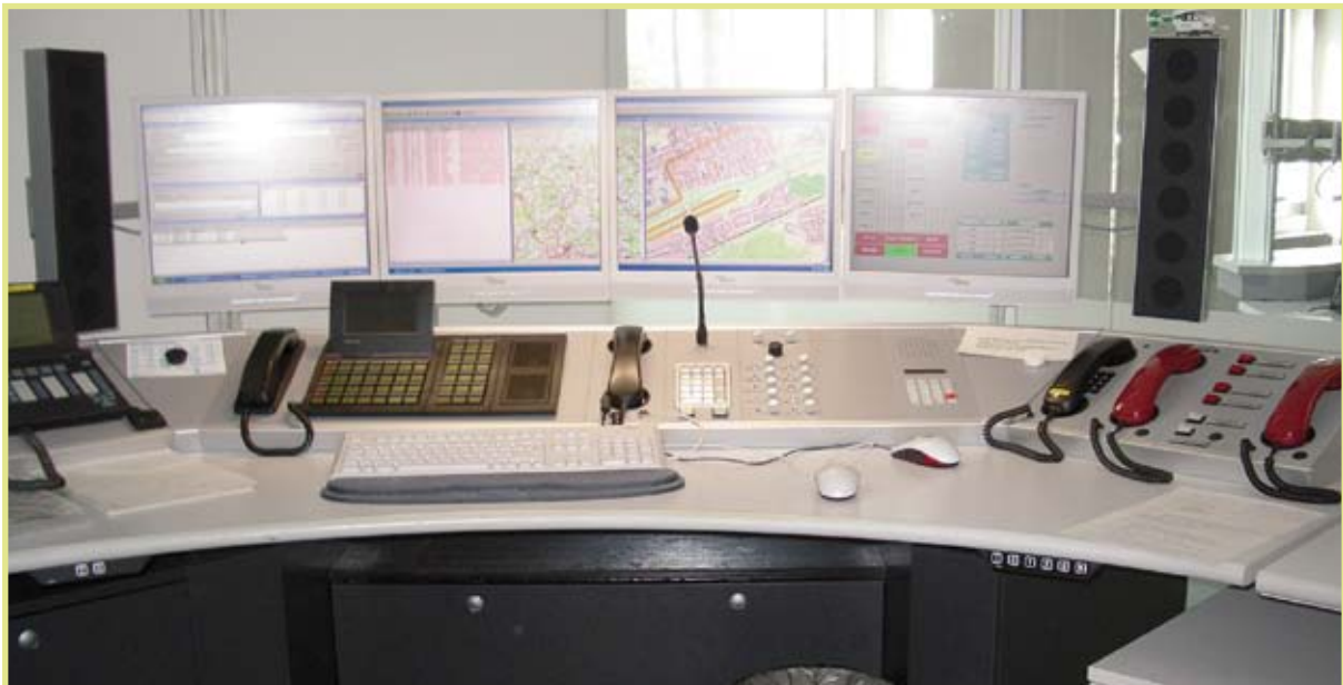
Notruf- und Serviceleitstelle (NSL)
